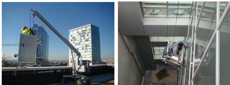
Figure 38 Nacelle pour entretien des façades
