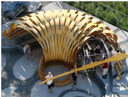
Figure 2.25 - Montage du pavillon ICD/ITKE 2010. Chaque bande de contreplaqué est maintenue par la précédente. Source ICD/ITKE, Stuttgart, 2010.
