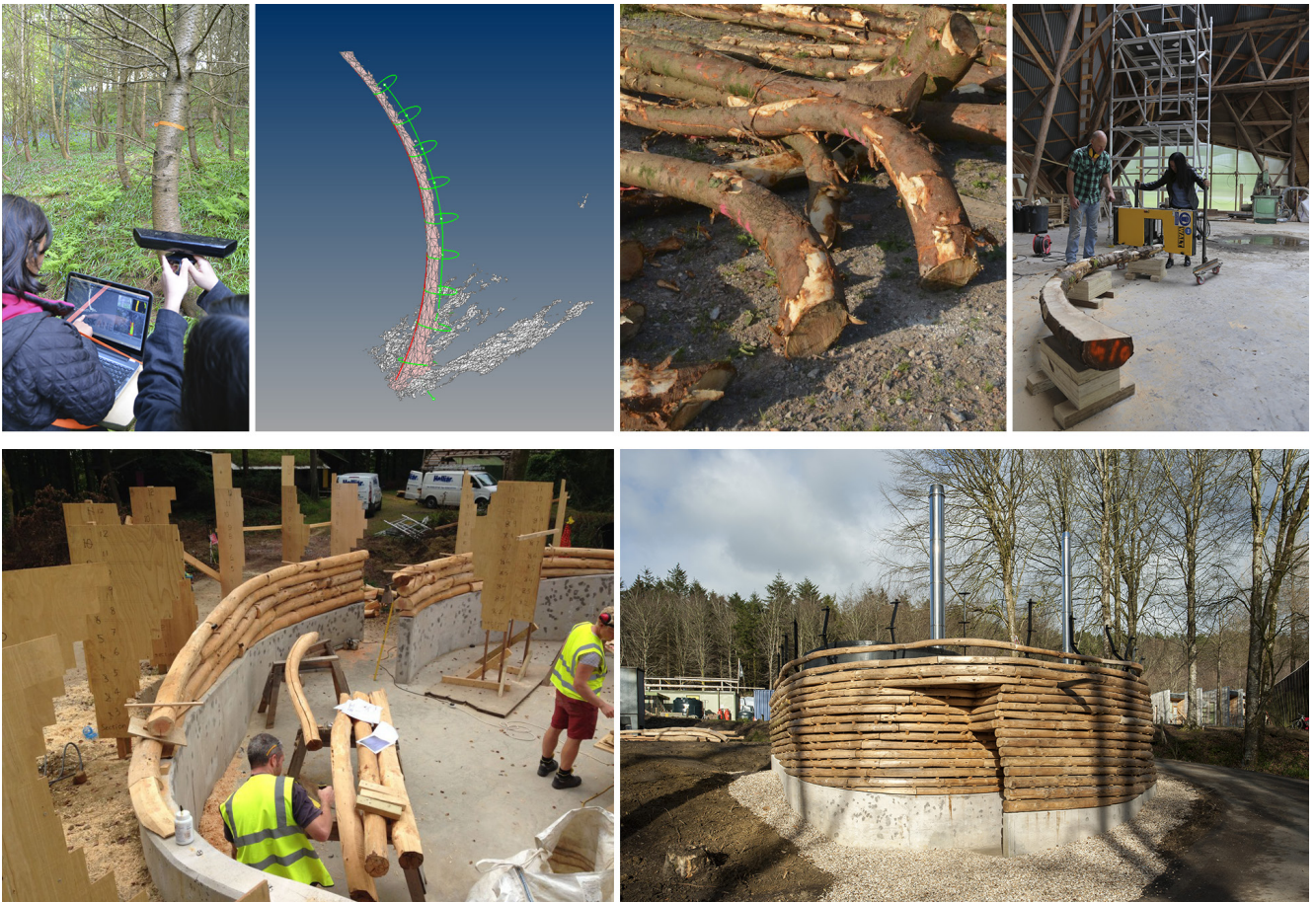
Figure 2.3 - La chaufferie du campus de Hooke Park est composée de 167 résineux. Ces derniers ont été scannés sur pieds pour déterminer numériquement une solution morphologique par empilement. Des gabarits en panneaux de bois ont permis de positionner les troncs débités selon le modèle numérique. Disponible à l'adresse : http://designandmake.aaschool.ac.uk/biomass-boiler-house/
