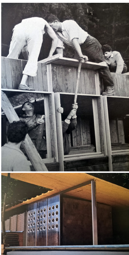
Figure 2.22 - Mise en œuvre des panneaux courbes de la toiture, maison Prouvé, Nancy. D'après (Prouvé, Stoullig, 2012).
