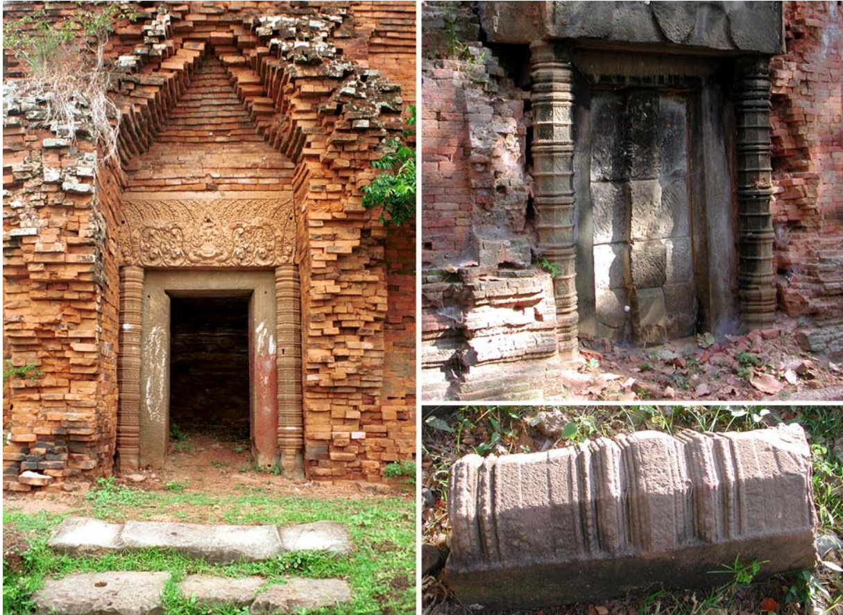
Figure 4-47 : Exemple de dégradations subies par les monuments khmers. A gauche le Prasat Sneng, en haut à droite des éléments du Prasat Prei Monti et en bas un fragment provenant de Vat Baset. (Photographies O. Cunin)
