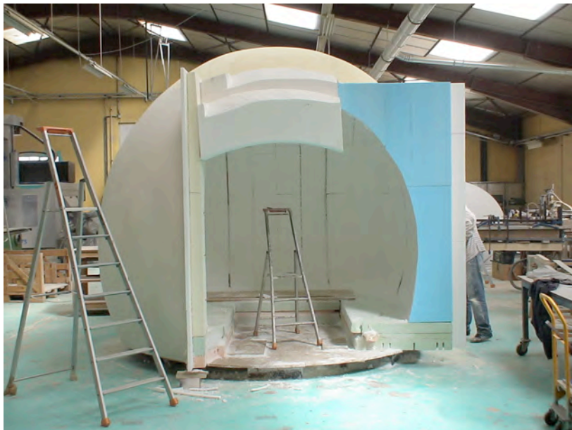
Photo N° 19 : Réalisation du moule d'une des « cabanes » de la crèche Jean Jaurès. Luc Boulais, conseillé pour la mise en œuvre des matériaux composites. (document fourni par l'architecte).
