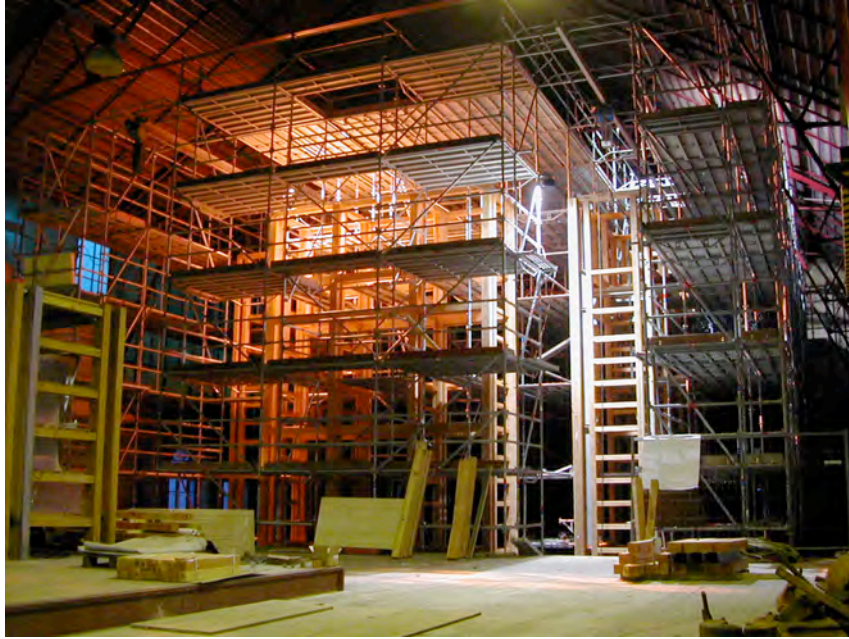
Vue du chantier du musée du cristal St Louis « incontestablement en bois » . Lipsky-Rollet, architectes. Document fourni par l'architecte
